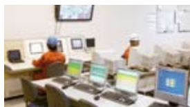
製造コントロール室(鹿児島工場)
